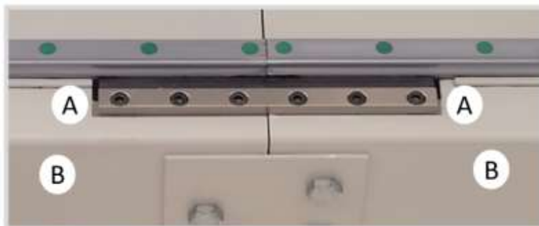
Ilustracja 6. Możliwe lokalizacje występowania pęknięć
