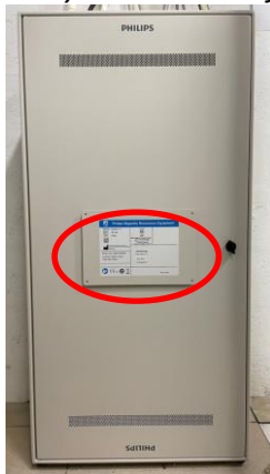
Ilustracja 2: Przednie drzwiczki głównej skrzynki rozdzielczej
