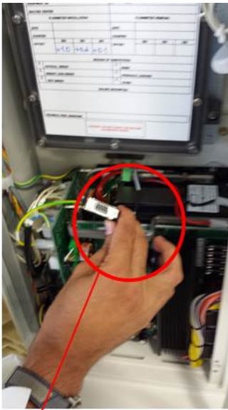
DFL-1 odłączone od czujnika przepływomierza masowego
