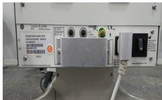
Rysunek 3: Serwo tlenowe NIE jest zainstalowane
