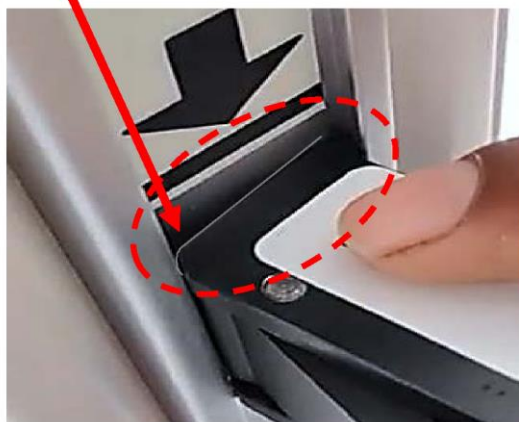
Rys. 3 Nieprawidłowy montaż z powodu wadliwego akcesorium montażowego o przekroju trapezowym (występowanie szczeliny lub otworu)
