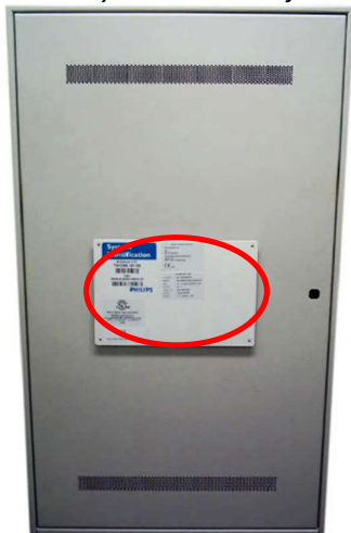
Ilustracja 3: Przednie drzwiczki głównej skrzynki rozdzielczej
